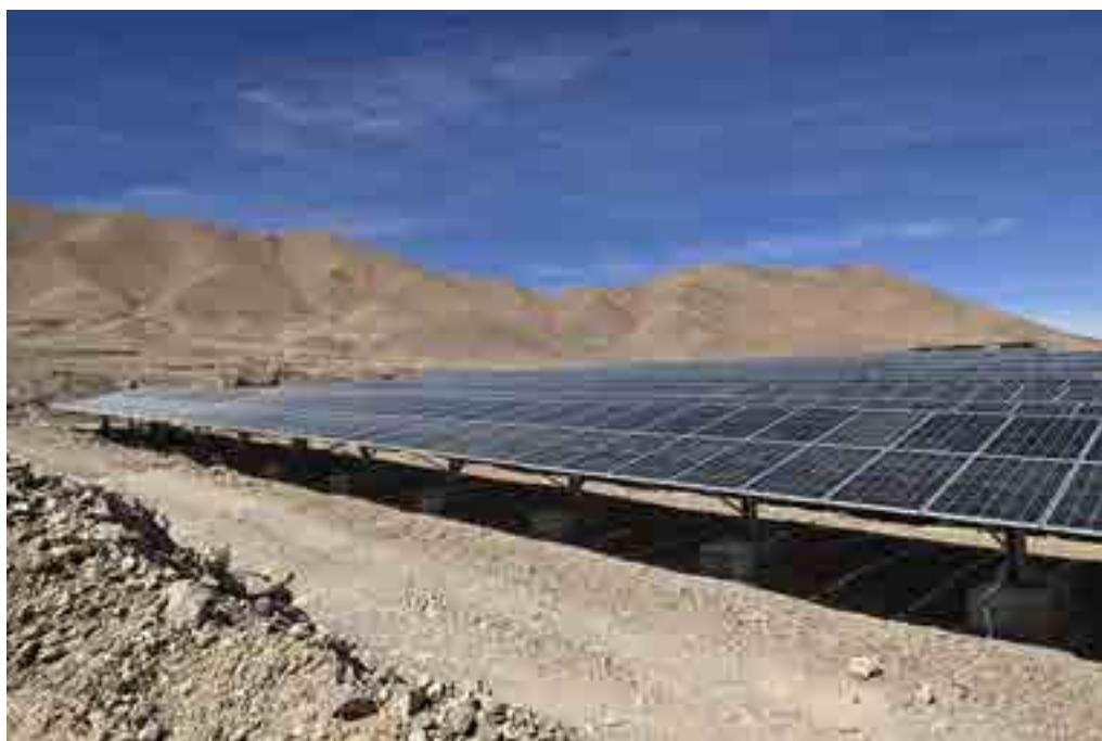
Proyecto de generación eléctrica híbrido fotovoltaico - gas licuado, II Región.
