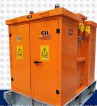
SUB ESTACION PAD MOUNTED CON PROTECCIONES PARA OPERACIONES INTERIOR/EXTERIOR MINA Y BASE PARA CONTENER DERRAMES DE FLUIDOS
