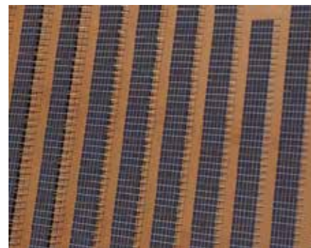
Planta Fotovoltaica El Romero Solar
