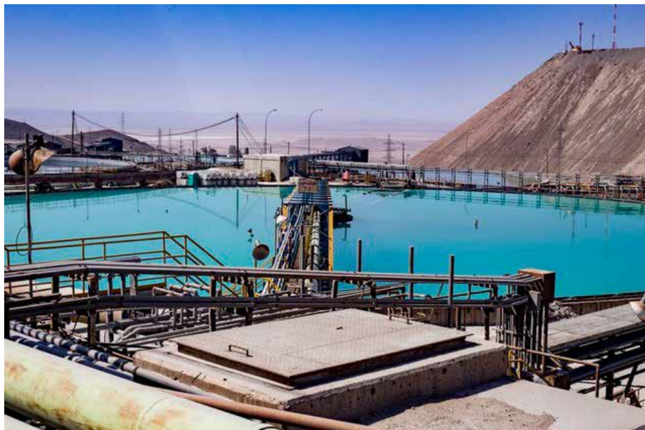
Planta Desalinizadora Distrito Norte
