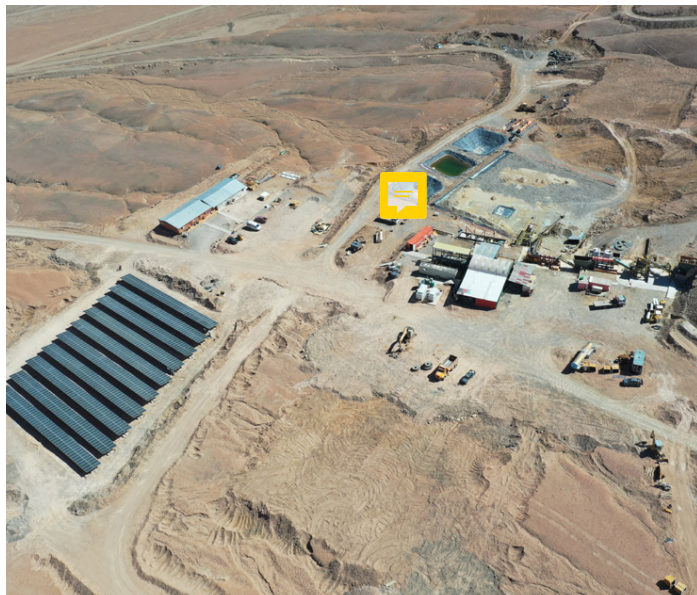
Planta Fotovoltaica Minera Tornosol
